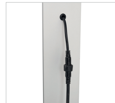
Câble d'alimentation positionné sous le cadre
